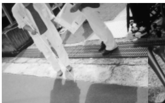
敷地出入口のコンクリート等がボロボロで車いすの使用に支障あり。
